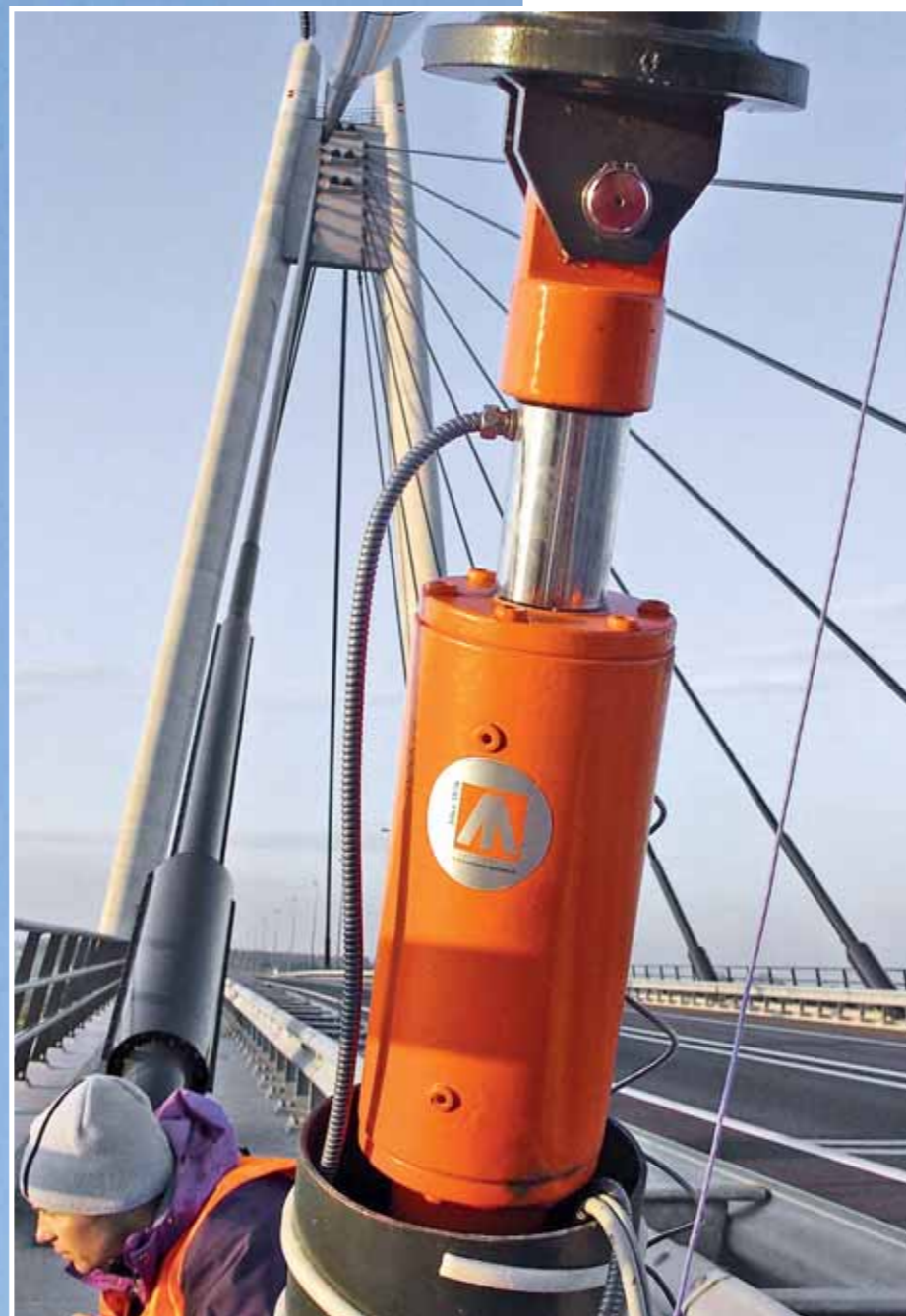
Erstmaliger Einbau adaptiver Schrägseildämpfer auf der IJssel-Brücke bei Kampen (Niederlande)
